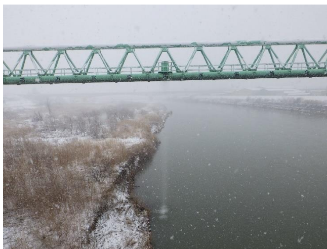
②-9 : SP (溶接) φ 700×2条 (空気弁から漏水)
