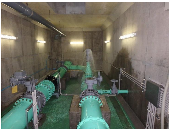
③-15：施設内配管の空気弁漏水
