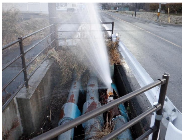
②-8 : SP (その他) φ 250 (管体亀裂)
