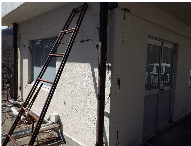
③-23：外壁にクラック
