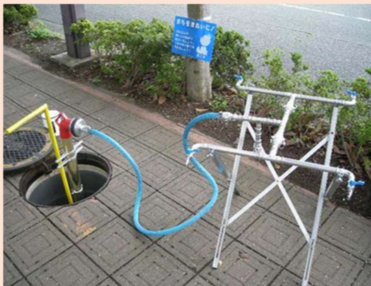
消火栓からの仮設給水栓
