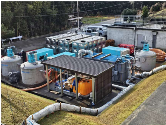
既設浄水機能の代替を目的とした可搬式浄水装置の設置 (珠洲市 宝立浄水場)
