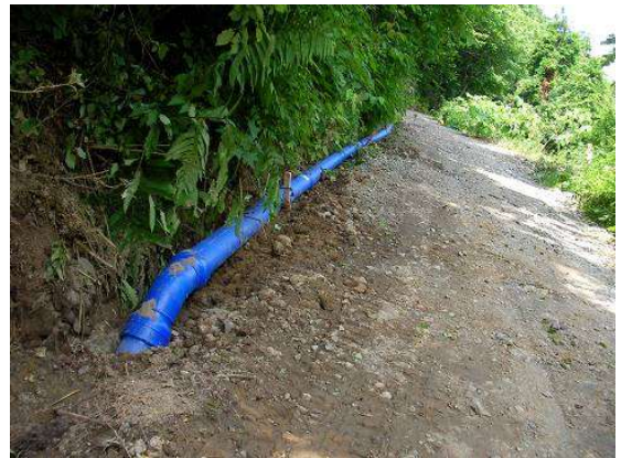
仮設配管(ポリエチレン管)
