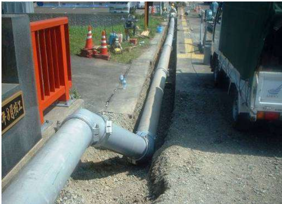
仮設配管(スチール管)
