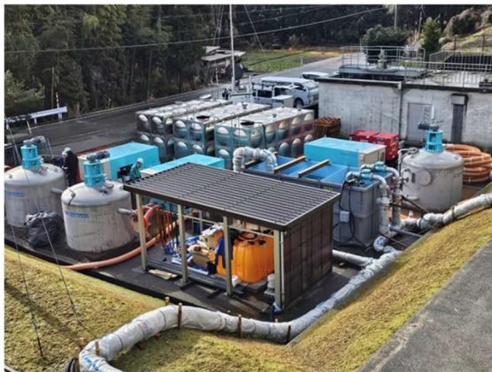
既設浄水機能の代替を目的とした可搬式浄水装置の設置 (珠洲市 宝立浄水場)
