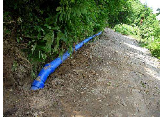
仮設配管(ポリエチレン管)
