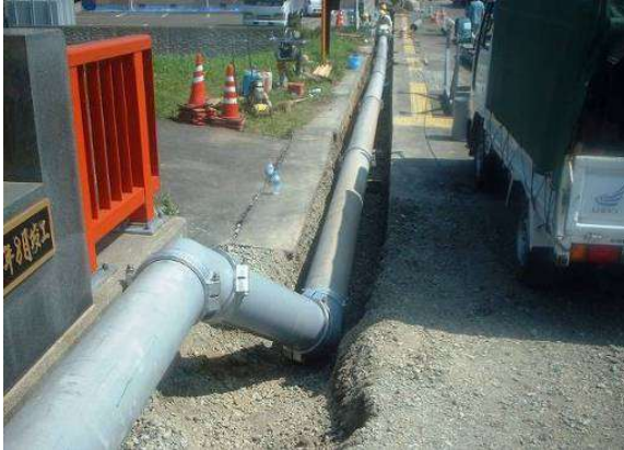
仮設配管(スチール管)
