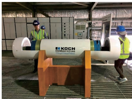
使用されている RO 膜 (米国製)
