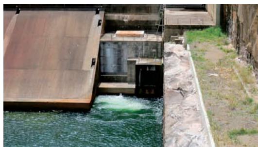
小水力発電装置
