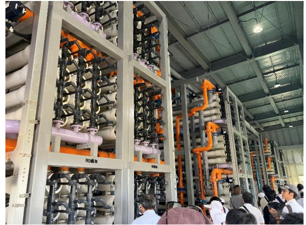
写真-15 RO膜処理施設
