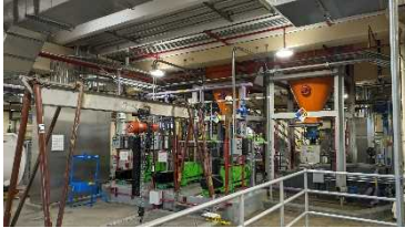
薬品注入設備
