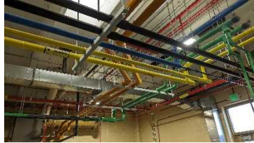
薬品注入配管
