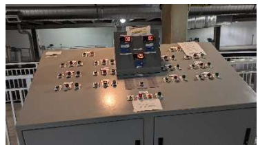
ろ過池操作盤
