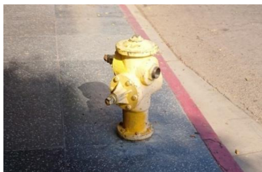
写真 ロサンゼルス市内に設置されていた地上式消火栓
