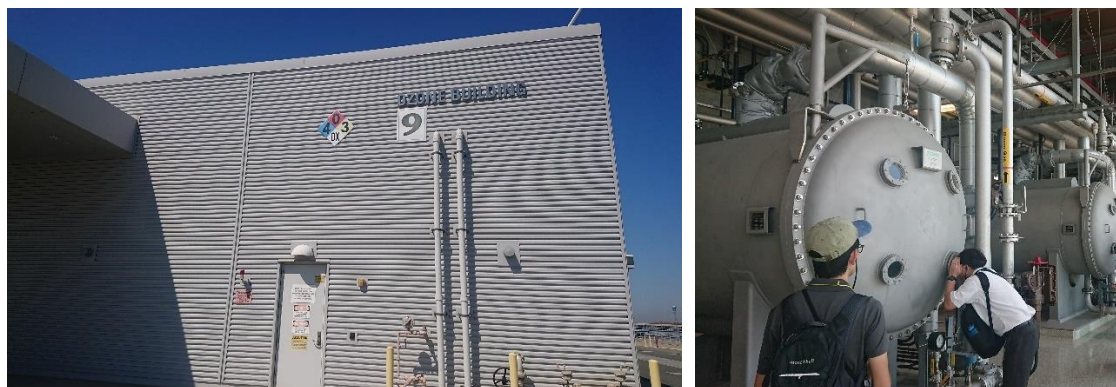
写真 Diemer 浄水場のオゾン処理施設（左：建屋外観、右：オゾン発生器）
