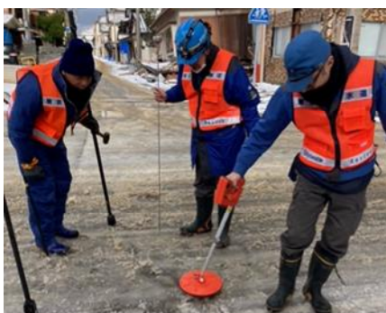
漏水調査 (令和6年能登半島地震)
