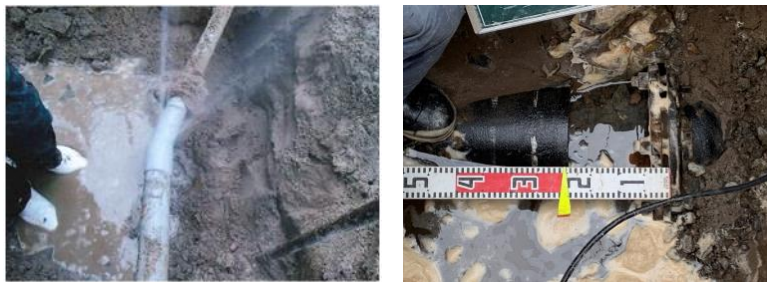
能登半島地震による水道管、下水圧送管の被災状況
